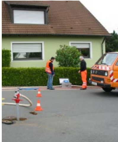
Bild 7: Nullverbrauchs- messung - Installation
